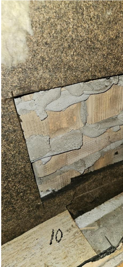
Bild 7 murbruk mot asfabord vilket kraftigt ökar risken för fuktrelaterade skador i yttervägg. (provplats 10)
