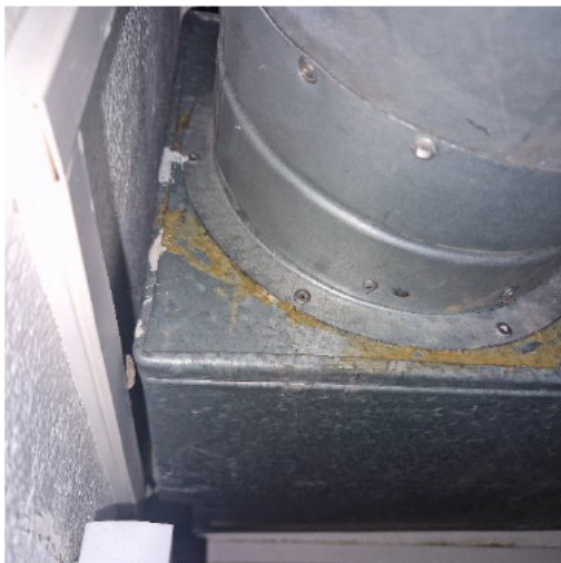
Foto 9 Tätkitt prov A1, asbest ej påvisad.
