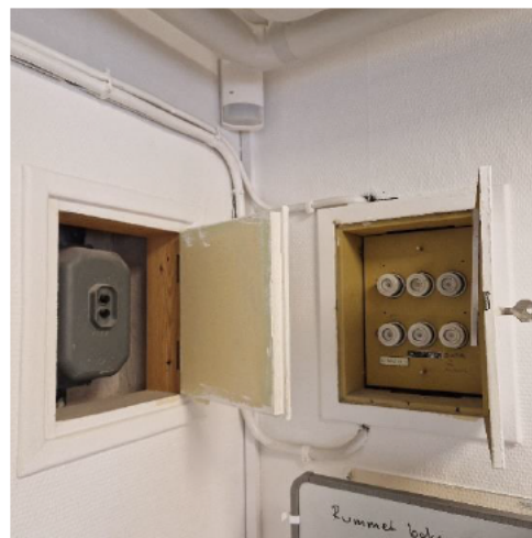
Foto 13 Äldre elinstallationer i hus B på det övre våningsplanet,
