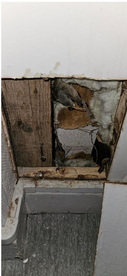
Bild 4 Mikrobiellt skadat trämaterial i utfackningsvägg under fönster (provplats 29)
