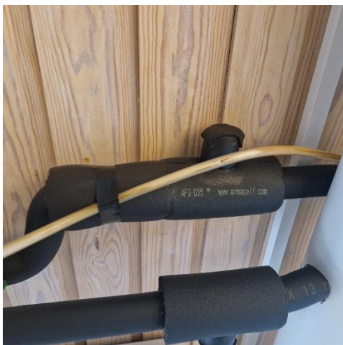
Foto Rörisolering märkt Armaflex.
