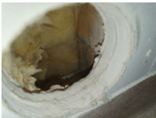
Bild 5 Provplats 20, rum 0121. Synlig mikrobiell påväxt på väggrelgel
