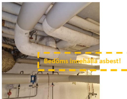
Foto 2 Vybild över rörböjar märkta "asbest".
