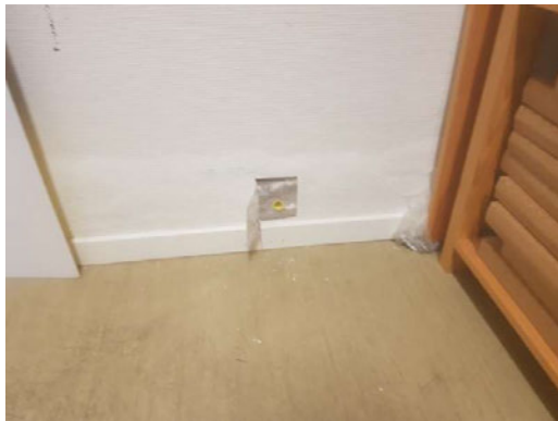
Bild 1 Yttervägg källare, väggytskiktet saknar vidhäftning närmast golv
