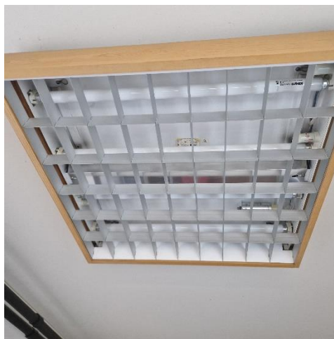
Foto 20 Armatur med metallkondensator.
