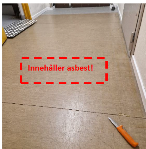
Foto 7 Plastmatta i källaren innehåller asbest.
