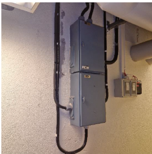
Foto 12 Äldre elinstallationer i källaren i hus B.
