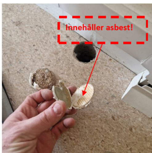
Foto 6 Den undre plastmatta i korridor på övre plan innehåller asbest.
