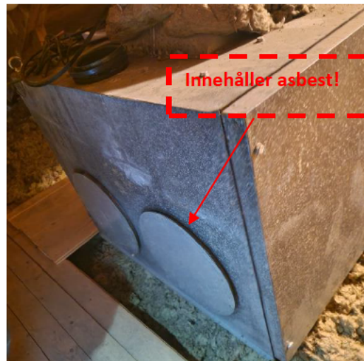
Foto 10 Tätkitt runt ventilationskanal. Asbest påvisad i prov A5.
