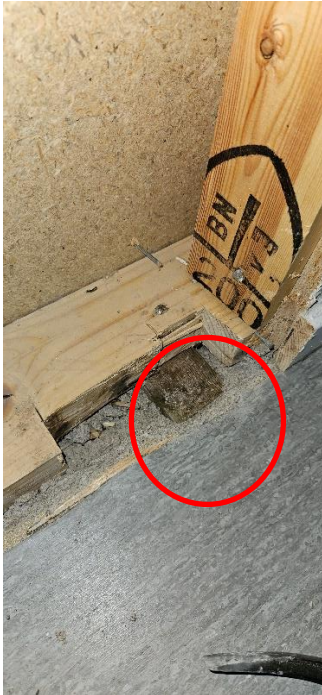
Bild 3 Ingjutna spikreglar under innerväggar, innehållande klorfenol och kloranisol (provplats 8)
