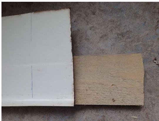
Bild 14 Invändig masonit med bakomliggande råspont närmast golv.
