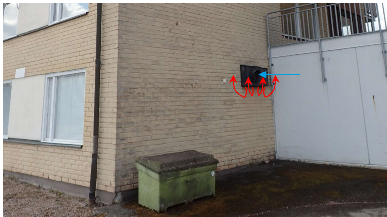
Bild 7 Felvänd kombihuv för inluft och avluft till lila område, bild 4. Röda pilar visar avluftens möjlighet att blåsas ut ur egentligt inluftsintag så luften kan sugas in på nytt i verkligt inluftsintag (blå pil).
