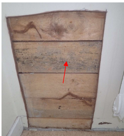
Bild 19 Synbart missfärgad råspont, sannolikt fuktskadad före inbyggnation. Röd pil visar provtagen inre råspont i rum 2010 enligt tabell nedan.
