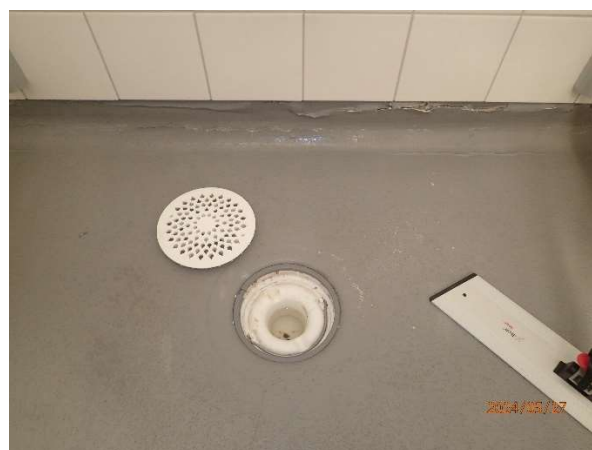
Bild 10 Golvbrunn typ Purus Oden för användning tillsammans med plastmatta eller tätskikt under klinker, har i omklädningsrummen använts tillsammans med endast betongfärg något som medför en otät tätskiktsanslutning i brunnar till duschar placerade inom orange yta bild 9.
