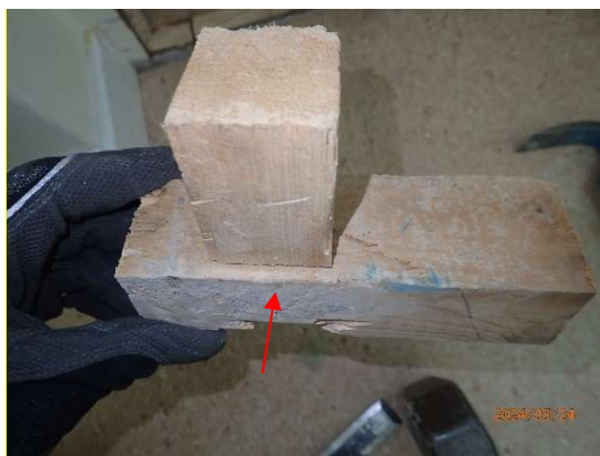
Bild 20 Syll till inre stående regel (röd pil) synbart fuktpåverkad på samtliga sidor. Provtagning av underliggande kil (syllfäste) i rum 2010 enligt nedan togs dikt angränsande syllen under markerad pil.
