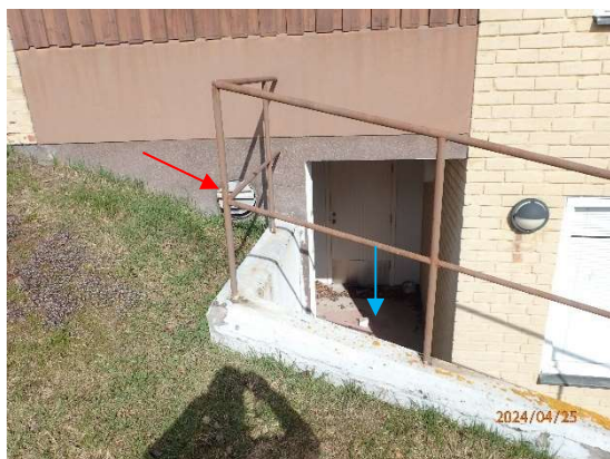
Bild 5 Placering av avluftsutblås till fläktaggregat i blått område, bild 4. Blå pil visar yta där avvikande lukt från avluften noterades vid ett av besiktningsstillfällena.
